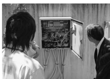
▲市役所内に各種センサーを設置
